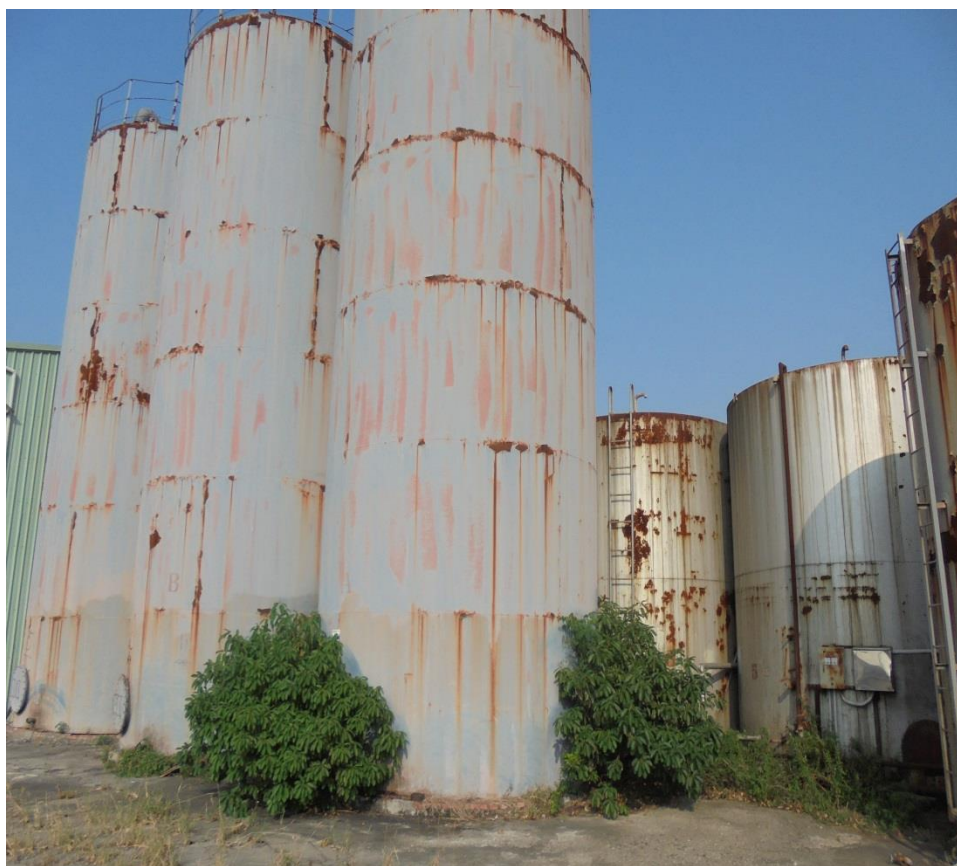
大型油槽(内含油品)
