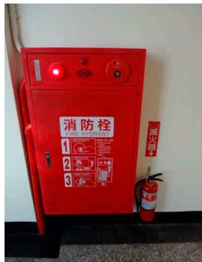
▲消防栓及乾粉滅火器
