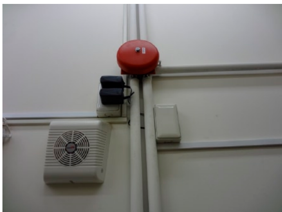
▲消防警鈴設備
