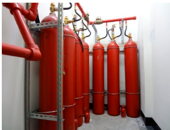
▲惰性氣體自動滅火設備
